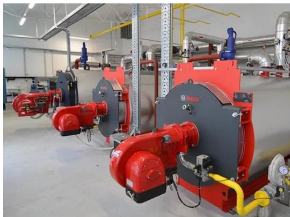
Picture 42.: Boiler room in Šorlijevo naselje
