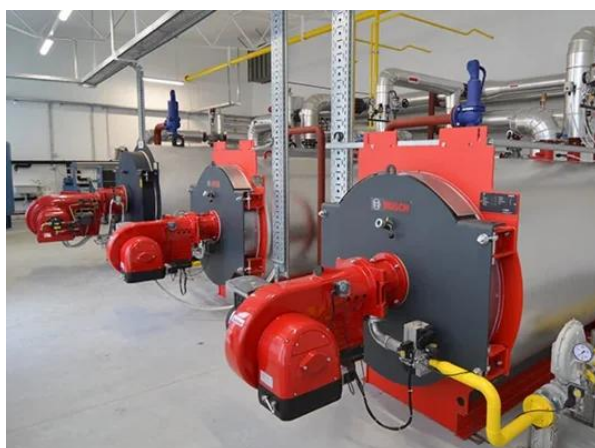
Picture: Boiler room in Šorlijevo naselje, source: https://www.domplan.si/energetika/toplotna-oskrba/prenova-ogrevalnega-sistema-sorlijevo-naselje
